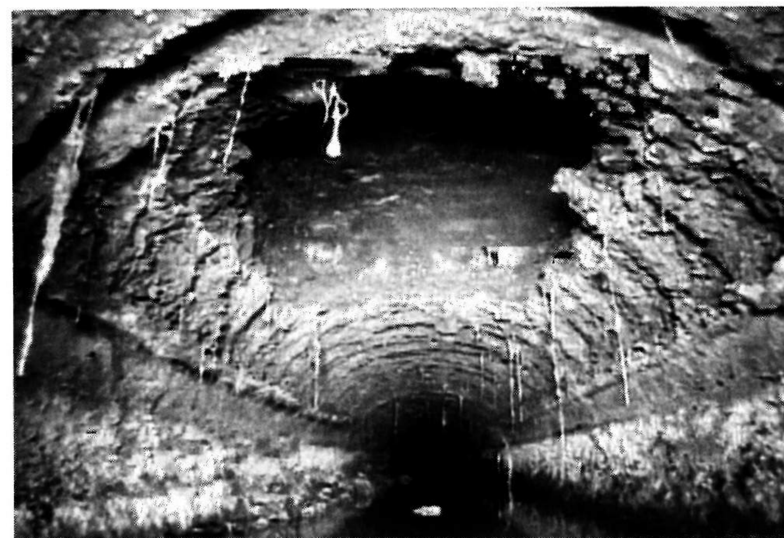
写真-5 天端が老朽化して空洞化している
