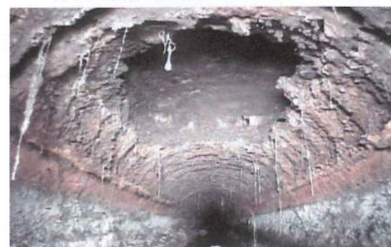
写真-2 陥没した上部空洞
