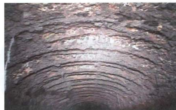
写真-1 上部硫化水素による腐食
