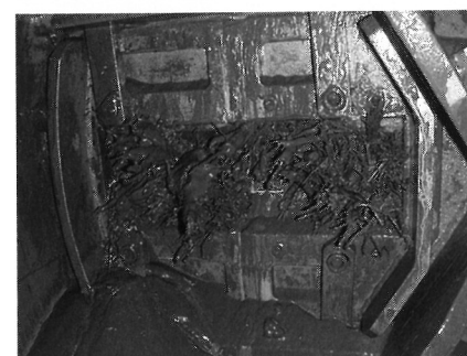
写真-6 木杭スリット閉塞状況
