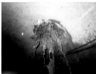
写真-1 玉石転動による推進管の破損
